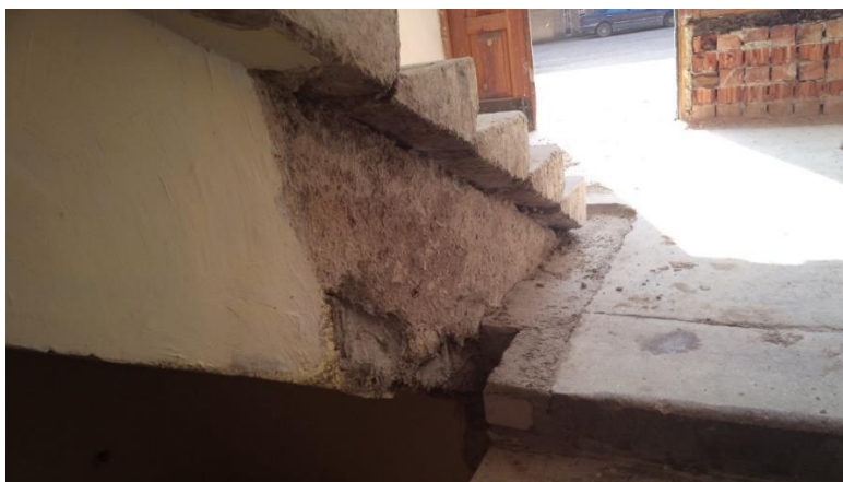
3 pav. Ties įėjimu iš lauko - erozijos pažeisti paviršiai, pastebimi armatūros korozijos požymiai
