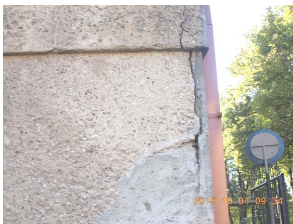
7 pav. Plyšys susidaręs dėl pamatų sėdimo, tačiau jo plotis didėja dėl temperatūros poveikio
