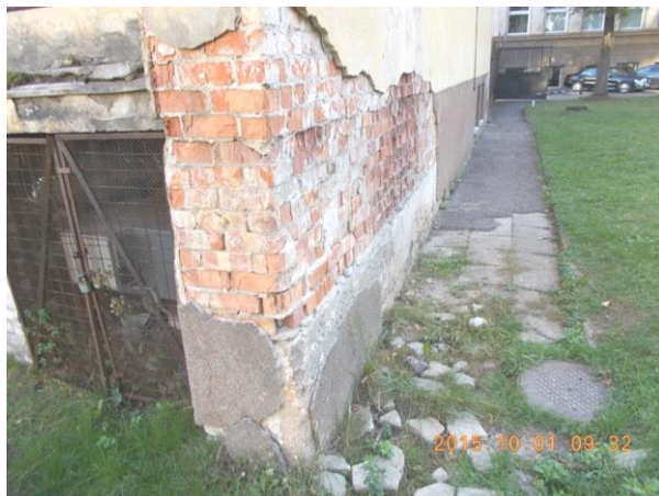
3 pav. Vyksta keraminių plytų irimas, erozija Šaltinis: sudaryta autorių
