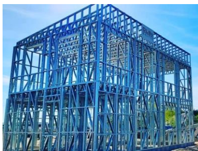
5 pav. Plonasienio plieno konstrukcijų karkasas [22]
