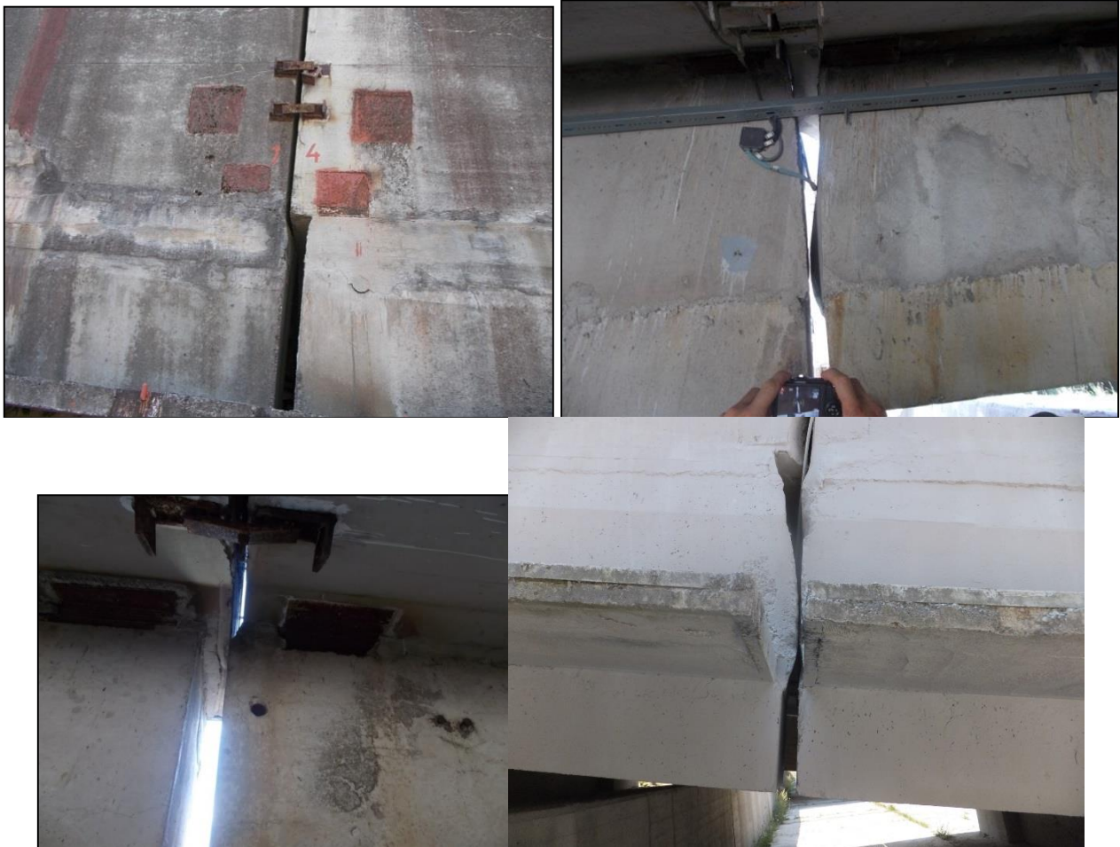
7 pav. Slėginių vamzdynų deformacijų kompensatoriuose atskirų elementų betonas liečiasi arba beveik liečiasi Šaltinis: sudaryta autorių
