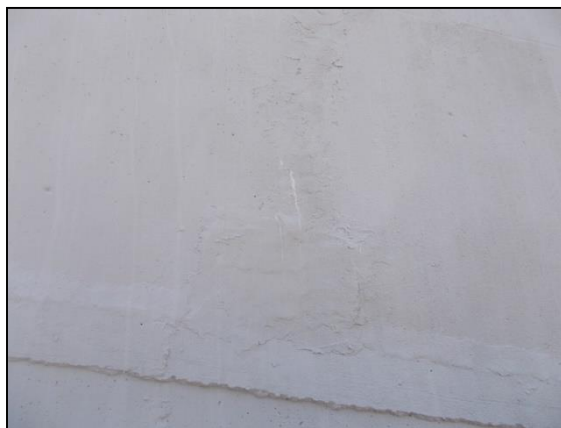
11 pav. Nežymus \text{Ca}(\text{OH})_2 išplovimas iš betono remontuotoje ir nudažytoje 3-ojo vamzdžio dalyje Šaltinis: sudaryta autorių
