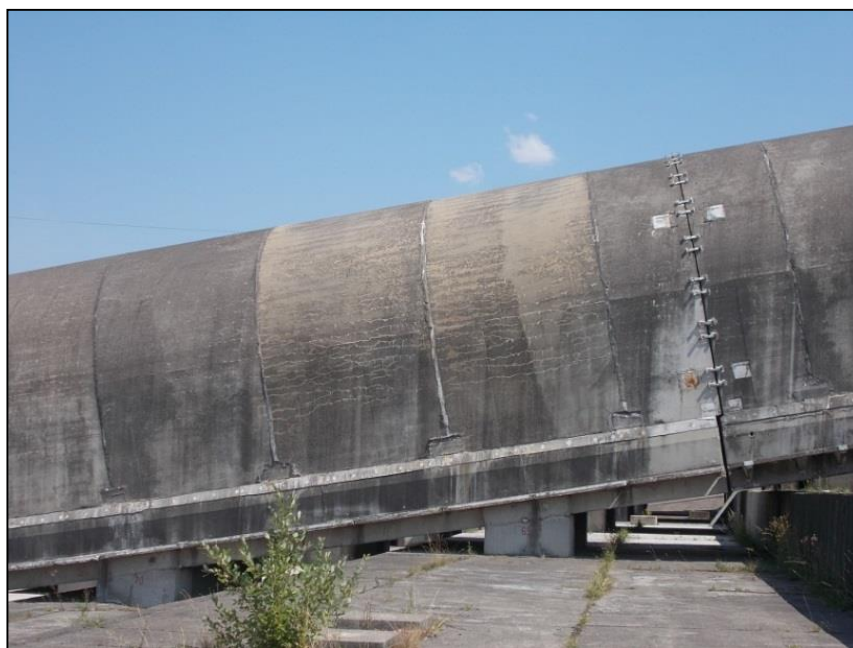
2 pav. Slėginio vamzdyno viršaus betoninio paviršinio sluoksnio pleišėjimas Šaltinis: sudaryta autorių
