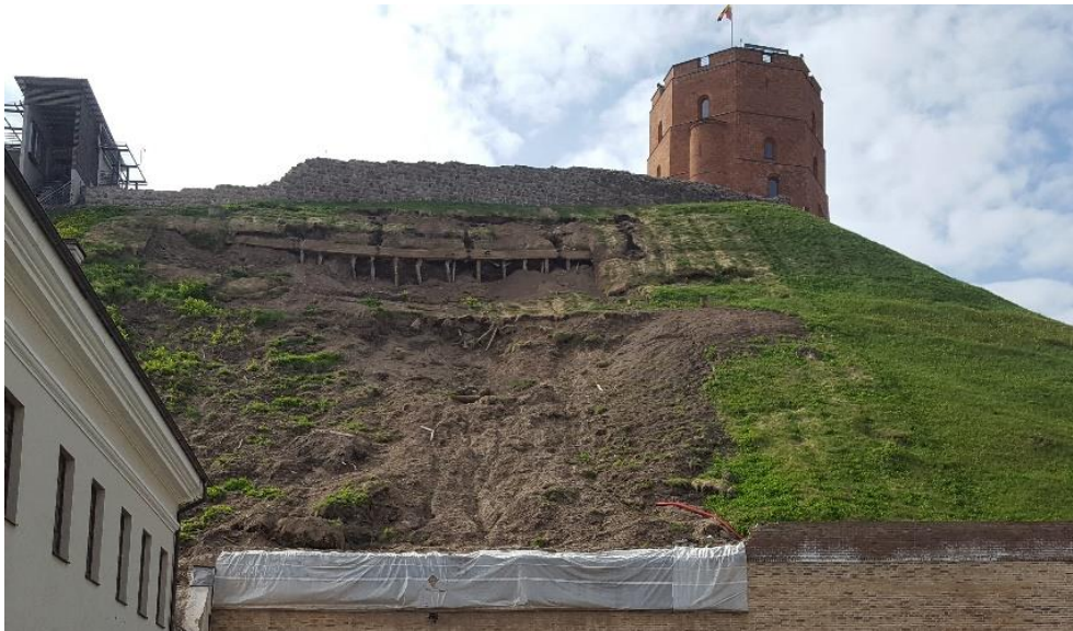
3 pav. Nuošliauža Gedimino kalno šiaurės vakarų šlaite
