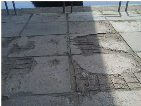
6 pav. Pažeistas paviršinis betoninis sluoksnis, apnuoginta armatūra
