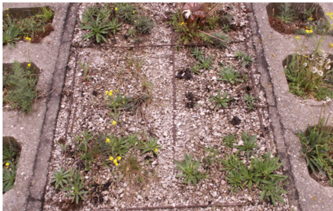
7 pav. Biokorozija Nemuno krantinės šlaitų tvirtinimo plokštėse, nuiręs paviršinis sluoksnis Šaltinis: fotografuota autorių
